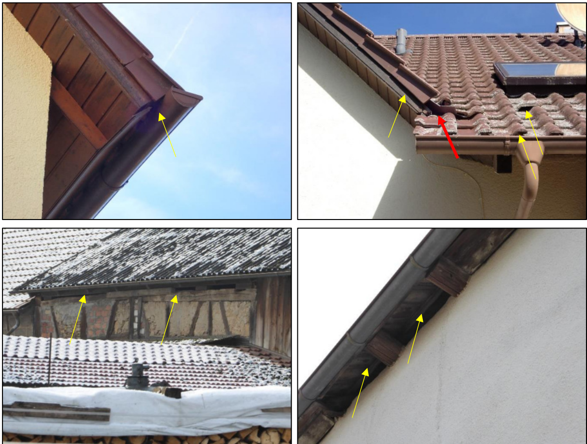
Abbildung 4: Einflugmöglichkeiten in den Dachbereich bzw. das Gebäudeinnere für Fledermäuse und Vögel und zugleich potenziell für gebäudebrütende Vögel nutzbare Nischen (gelbe Pfeile) durch Schadstellen (links oben), Lüftungsziegel, Öffnungen im
