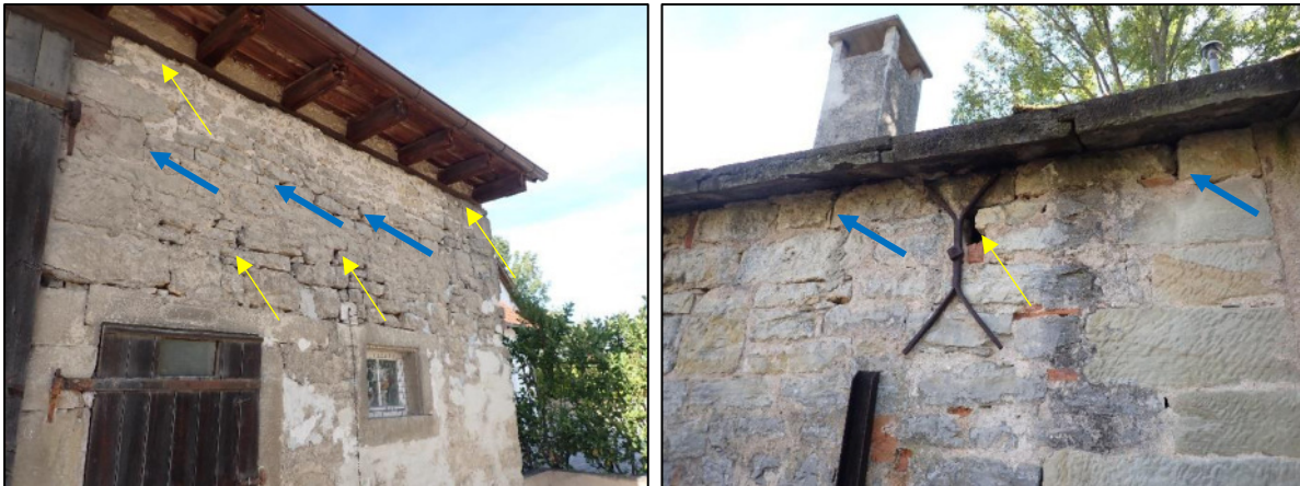
Abbildung 8: Einflugmöglichkeiten (gelbe Pfeile, exemplarisch) für Vögel und Fledermäuse und potenzielle Spaltenquartiere (blaue Pfeile, exemplarisch) für Fledermäuse an alten Gebäuden mit Natursteinfassaden innerhalb des Untersuchungsgebiets.
