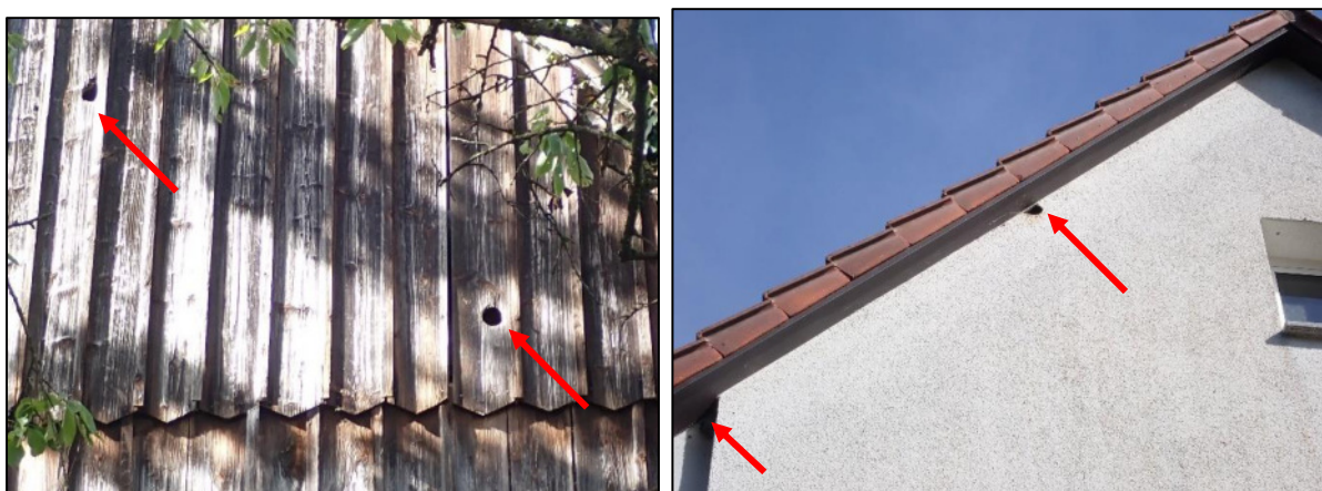
Abbildung 7: Spechtlöcher (rote Pfeile) an einem Holzschuppen auf Flurstück Nr. 3018 (links) und der Fassade des Wohnhauses Husarenhof Nr. 4 auf Flurstück Nr. 2932 (rechts).
